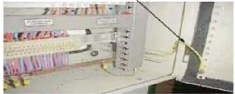
خزانة مراقبة كهربائية مجهزة بسلك أرضي.
