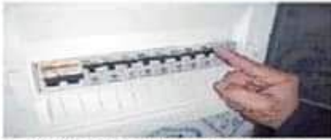
مجموعة من القواطع الكهربائية
